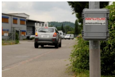
Zählgerät an Kandelaber montiert
